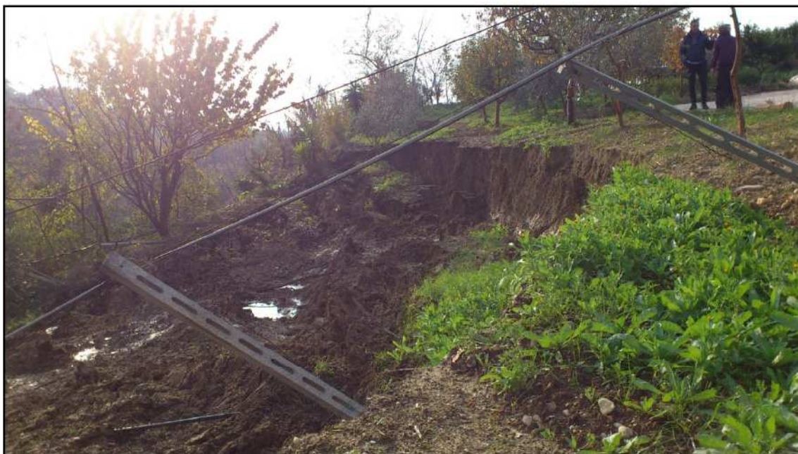
Foto 1 – Frana vista laterale. Dicembre 2013.
